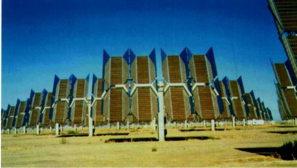
شكل (2-21): محطة توليد كهربائية تستخدم مجمعات شمسية ذات قطع اسطوانية مكافئه
